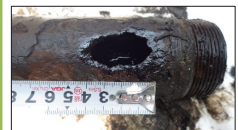
【腐食した埋設配管】
