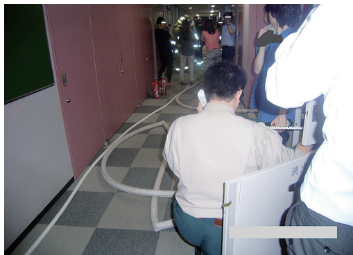
写真2-2 補助散水栓の使用状況
