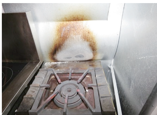
写真1-1 大型ガスこんろの状況
