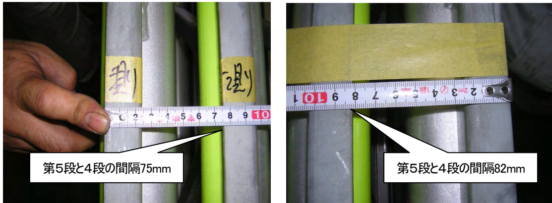
写真6 梯体昇降機用レール
