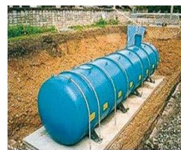
【耐震性貯水槽】
