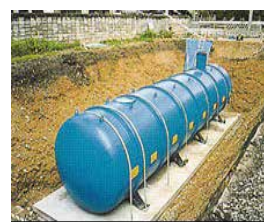
【耐震性貯水槽】
