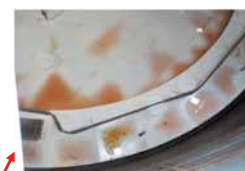
【内部浮き蓋上の滞油の状況】
