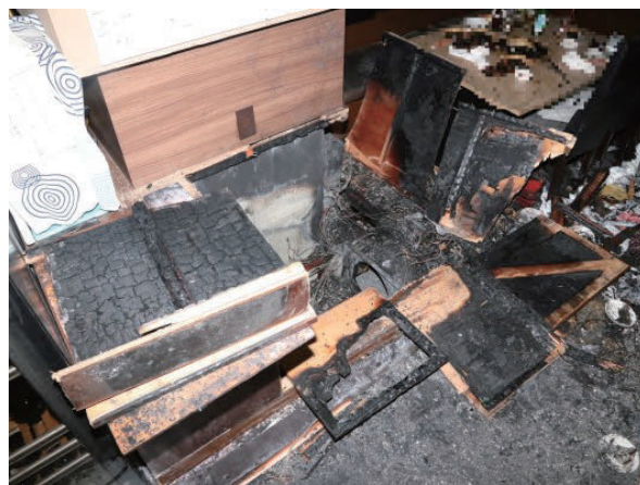
写真 1－2 焼損した客席の状況
