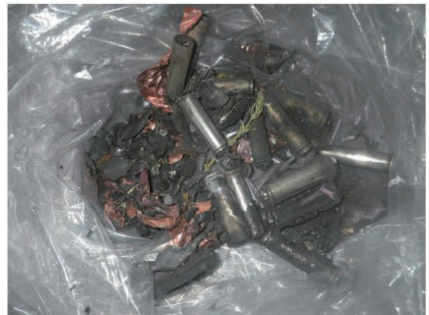
写真2-2 バッテリーセルの焼損状況
